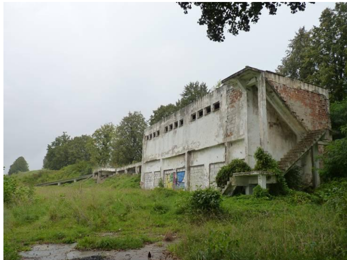
Zdjęcie. Zdewastowana zabudowa nad brzegiem jeziora Mikołajskiej w części południowej terenu objętego opracowaniem.
